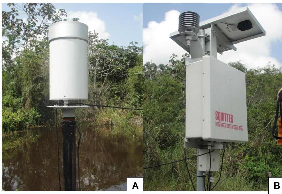
Figura 7 Pluviômetro de báscula da Squitter do Brasil (A) em conexão com a PCD Natuba onde fica instalado o data logger memory (B), ambos instalados na microbacia Natuba 2.
