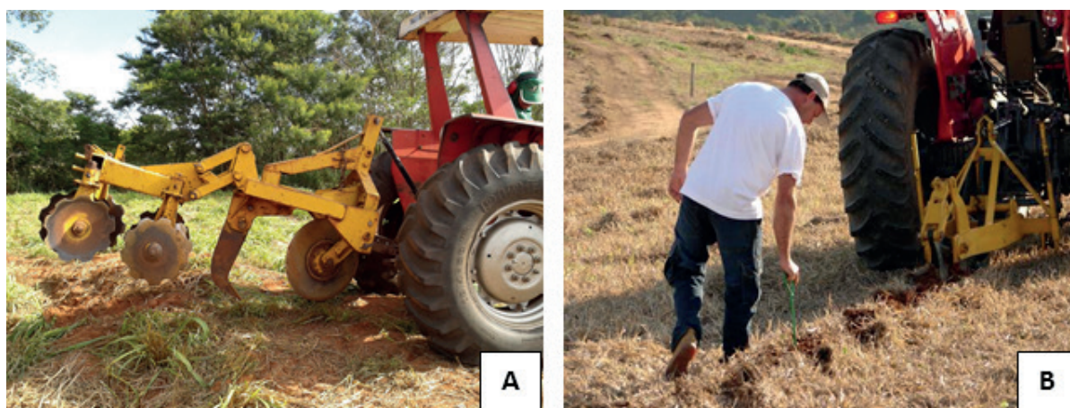
Figura 17 – Exemplos de área com o mato já seco, após aplicação de herbicida, (A) sendo preparada para o plantio com um subsolador florestal e (B) técnico medindo a profundidade de subsolagem com uma haste de ferro.
